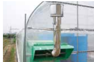
■外気吸入ダクト
