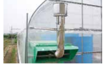
■外気吸入ダクト
