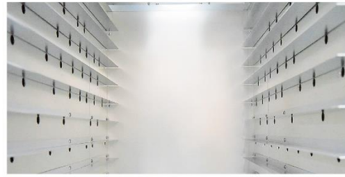
乾燥機内部には温風の吹き出し口が左右の側面にいくつもあり、乾燥むちを防ぐ
